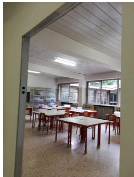
Con pareti di cartongesso ricavate tre aule nella mensa del plesso di via Sant'Uguzzone
